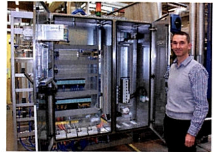
Udo Krüger, Plattform-Manager bei Tetra Pak Processing im Geschäftsbereich Dairy & Beverage, in der Fertigung in Lund; jeder Steuerschrank basiert auf standardisierten elektrotechnischen und mechanischen Komponenten, wobei die Varianz über alle Prozessmodule minimiert ist. Bild: Deltalogic
